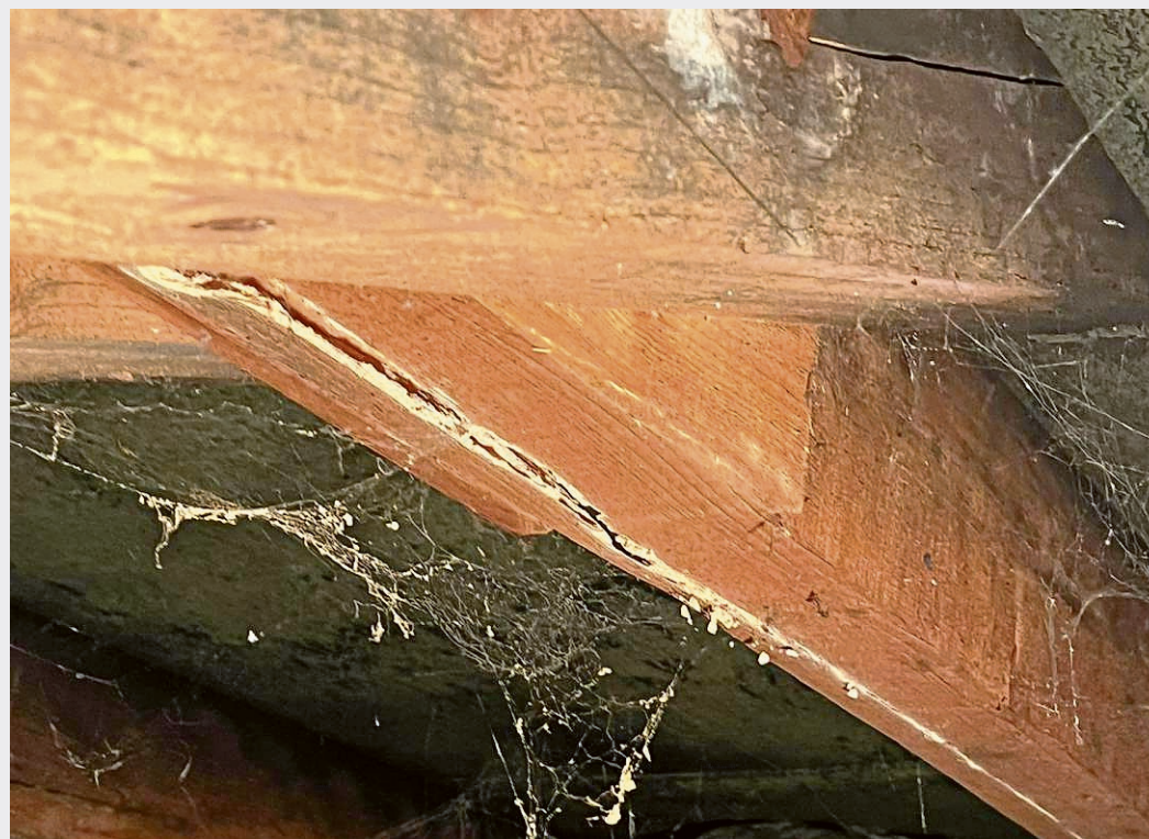
Une fissure s'étendant sur plusieurs dizaines de centimètres s'est formée sur une poutre de la charpente, la fragilisant.
